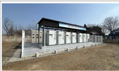
공유형 ESS 설치(4.8MWh)
