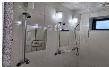
편의동 샤워실 내부 (시설 노후 및 칸막이 부재)
